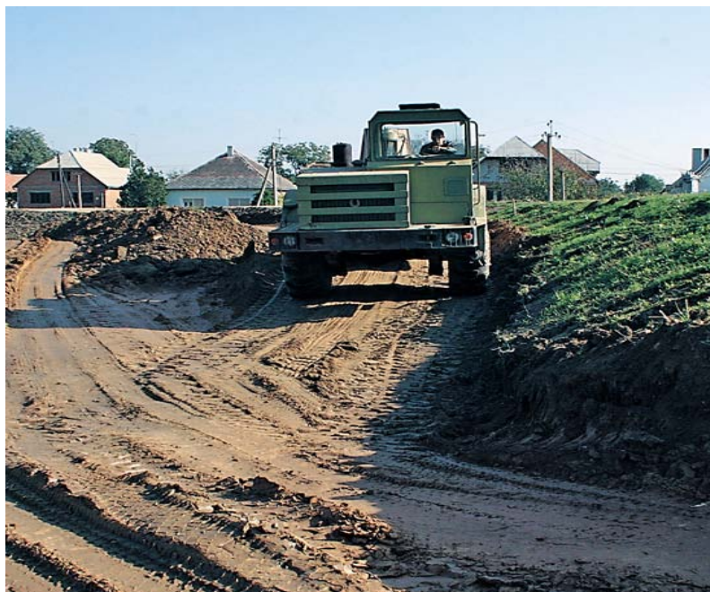
Будівництво захисної дамби в басейні річки Чорна Тиса на Закарпатті. Фото Олександра ЛЕПЕТУХИ
